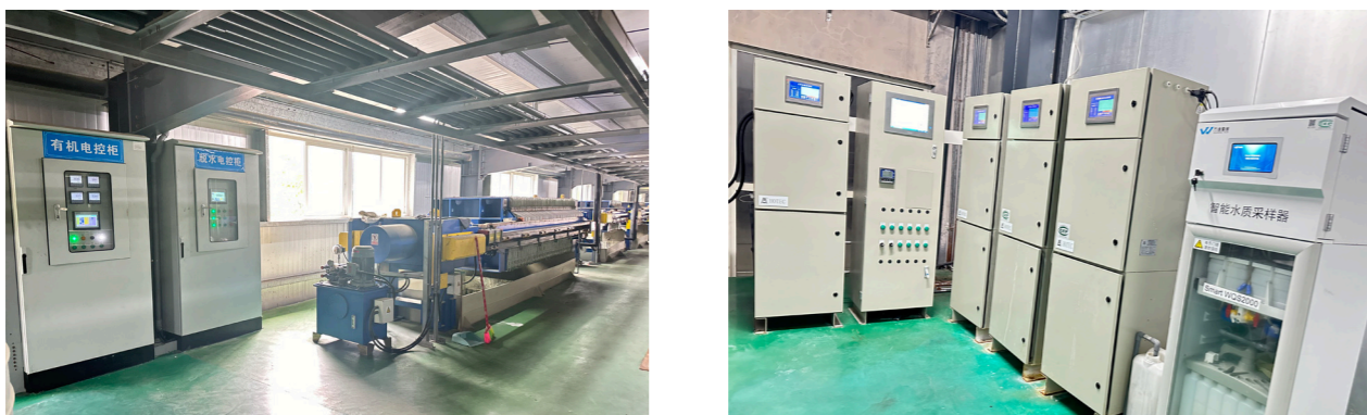
废水在线监测设施
